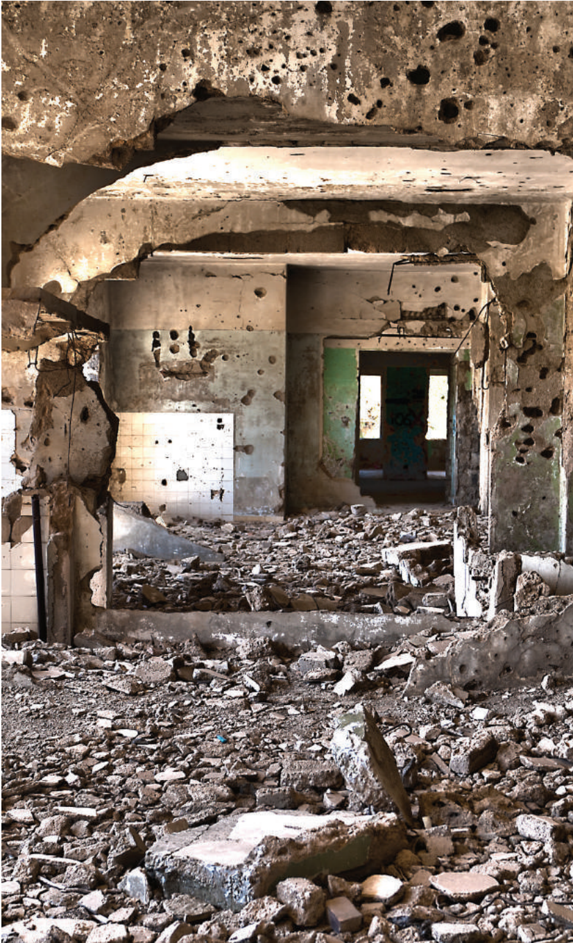
بناء مهدم في سوريا. الصورة من: أدوب ستوك إيميجز
